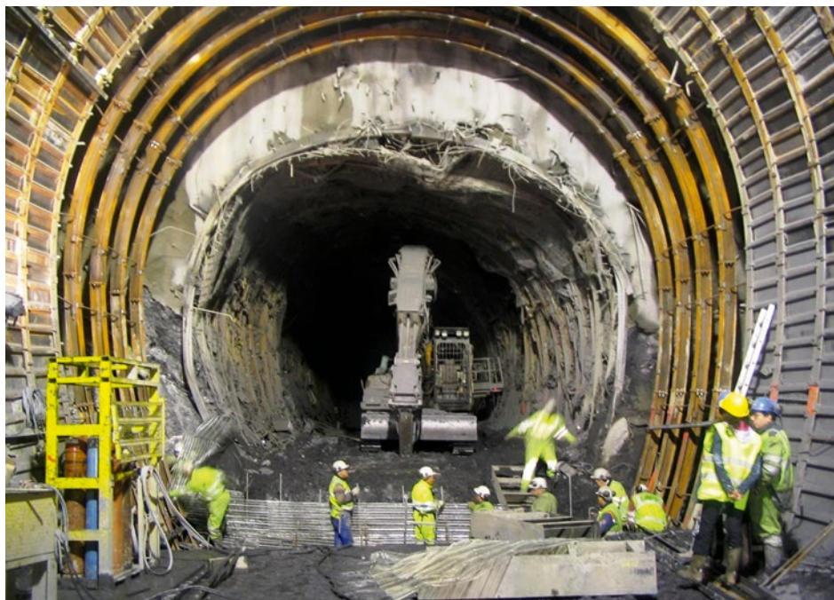
Tunnel Lyon Turin – Descenderie de Saint Martin la Porte – Fortes convergences dans les schistes du Houiller (Eiffage)
